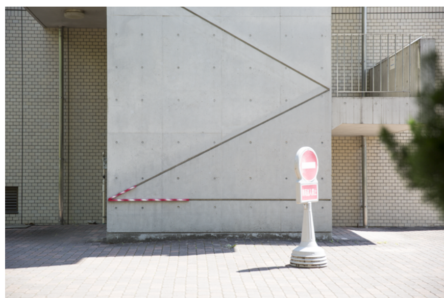
「この壁を作ったときも、溝の部分に角材を当ててコンクリを流したはず」(角材、塗料)
